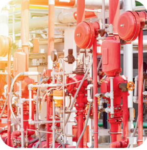
Yangın tesisatı sistemleri
