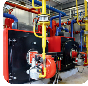
Merkezi ısıtma ve soğutma sistemleri
